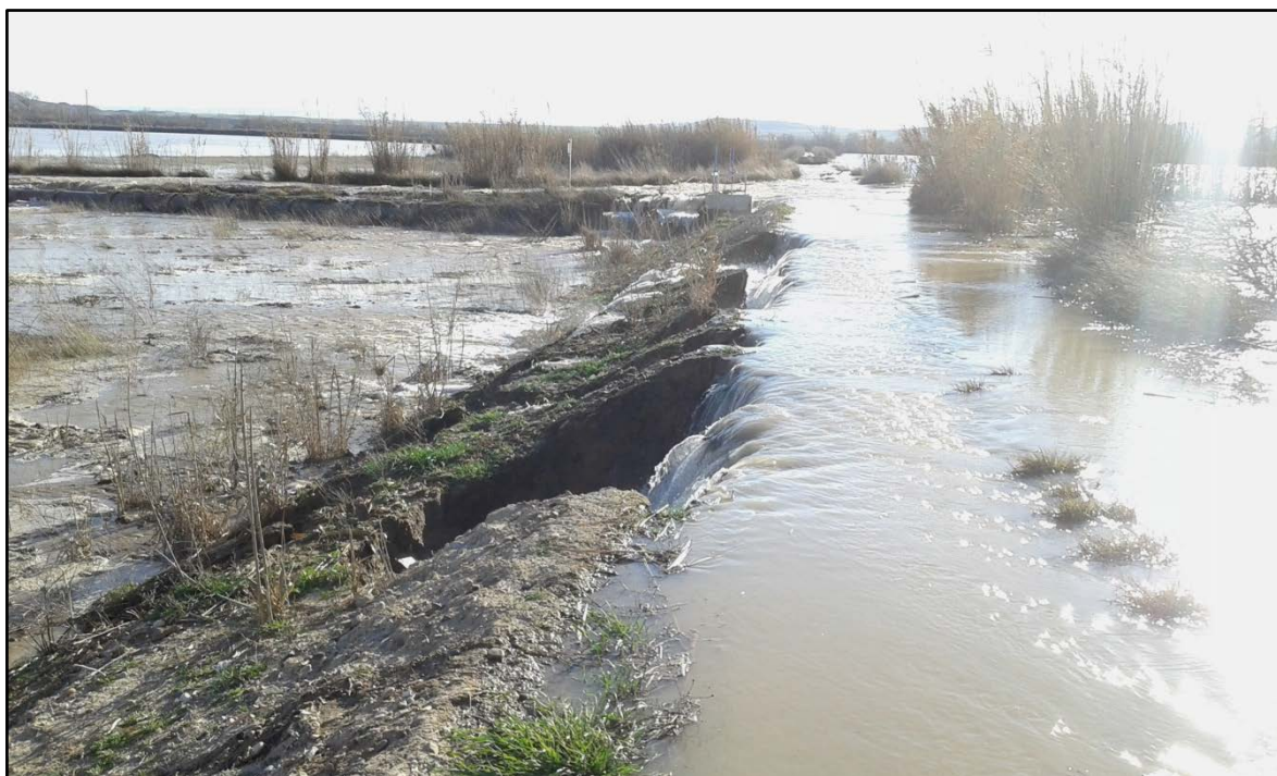
Figura 11. Dique de defensa siendo desbordado y erosionado en su trasdós (Confederación Hidrográfica del Ebro).
